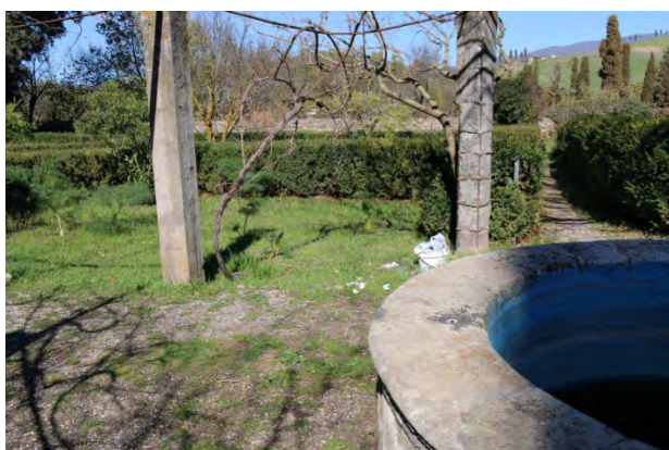
Fig. 48 - Pilastrini pergola con ferri armatura Scoperti e residui edili. Marzo 2024. (Foto di Maria Luisa Caruso di Maniace).
